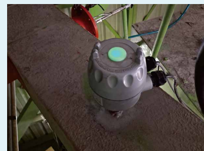
集塵機粉塵濃度偵測
